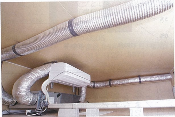
エアコン1台で冷温風を吹き込み、ファンを利用して全室へ送り込むことで室温を一定に保つ
